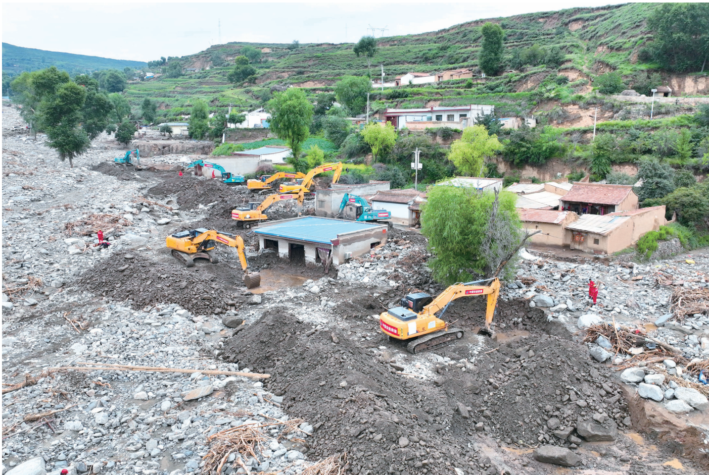
榆中县山洪泥石流灾害重灾区现场（摄于8月11日）
