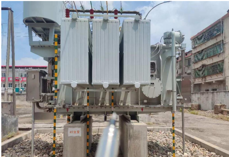
图 2.3-3 泗湖山 35kV 变电站 2 号主变
