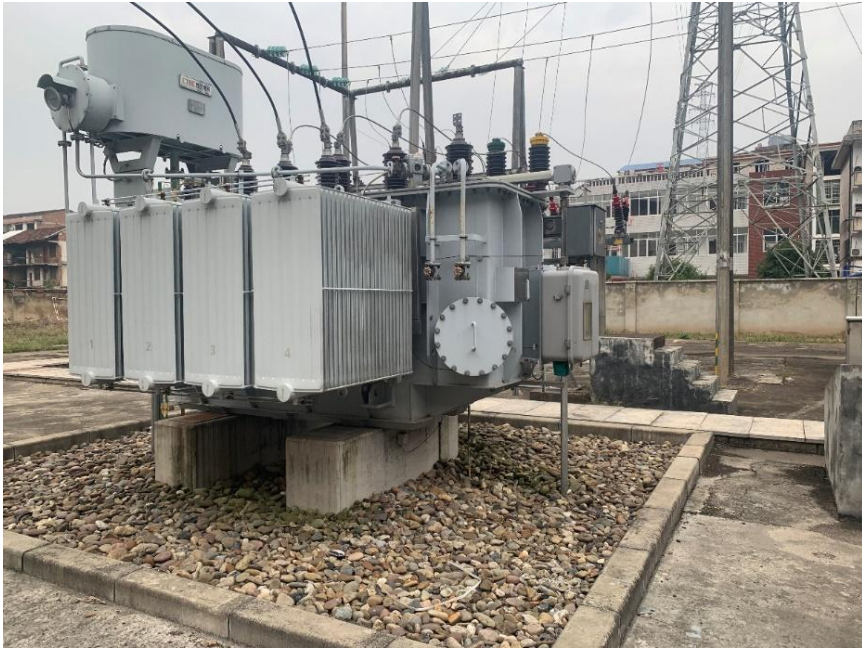
图 2.3-2 泗湖山 35kV 变电站 1 号主变
