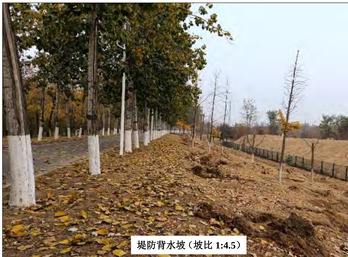
图 3.1-6 堤防背水坡现状图
