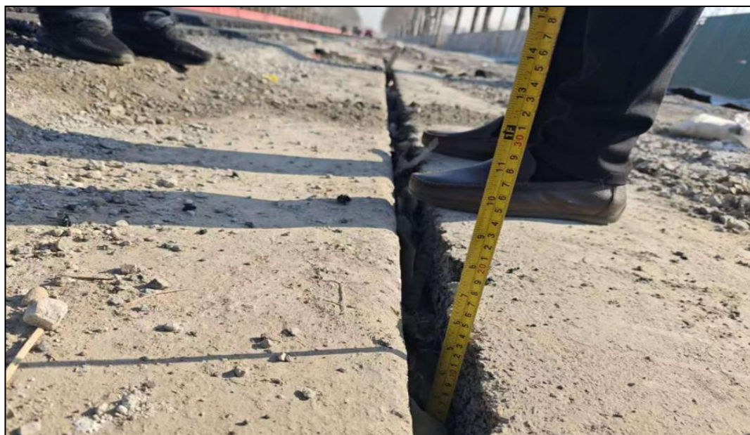
图 1.1-3 影视城路南侧路面现状
