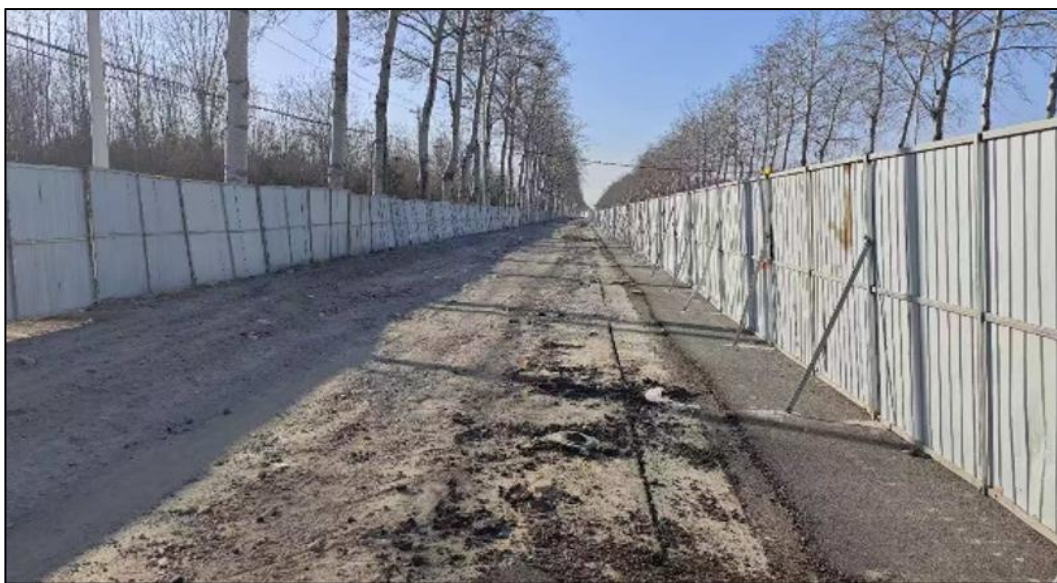
图 1.1-2 影视城路南侧路面现状
