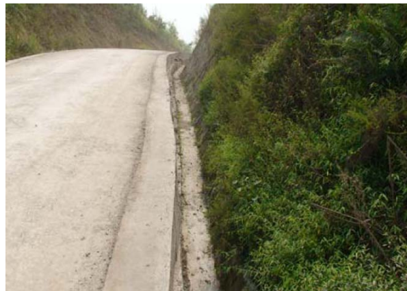
库区道路排水系统
