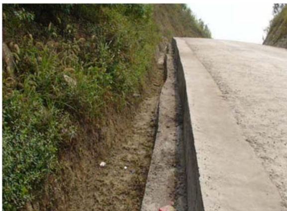
库区道路排水系统
