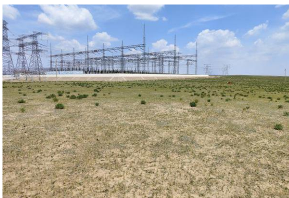
巴林变 500kV 出线端及施工生产生活区
