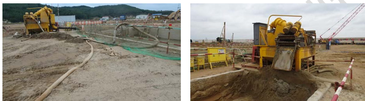
泥浆过滤装置
