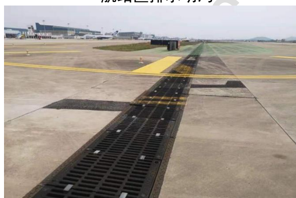
飞行区盖板排水沟
