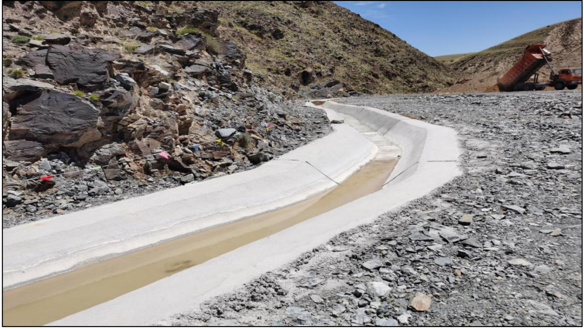
混凝土截水沟
