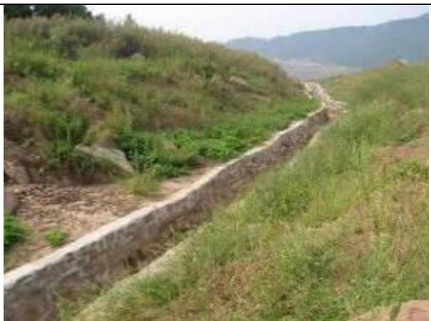
弃渣场截排水措施
