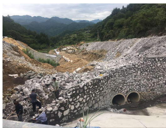
杨梅岭隧道出口弃渣场排水涵管
