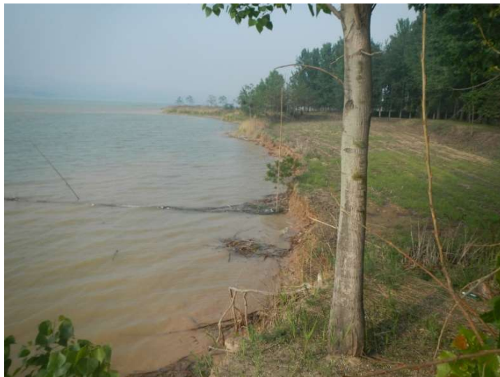
官庄工程处坍塌
