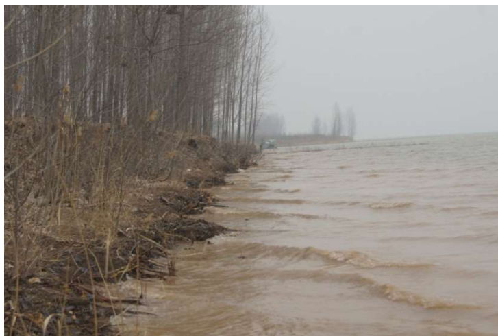
疙瘩涧工程处坍塌
