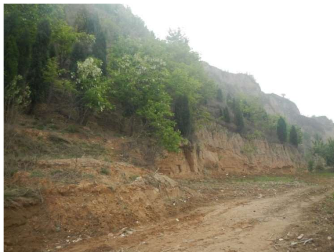
东坡工程处坍塌
