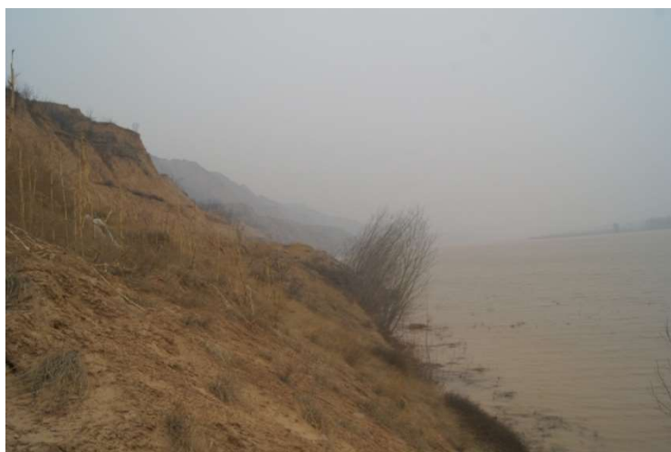
沟南工程处坍塌
