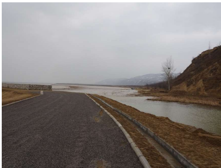
东古驿工程处坍塌
