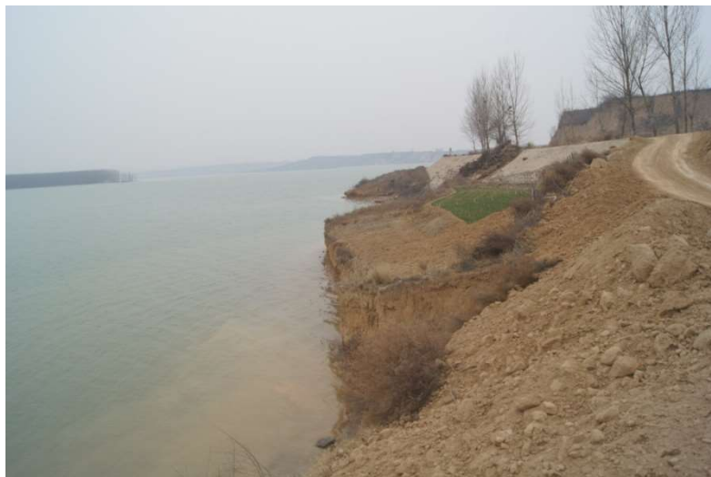
西延工程处坍塌
