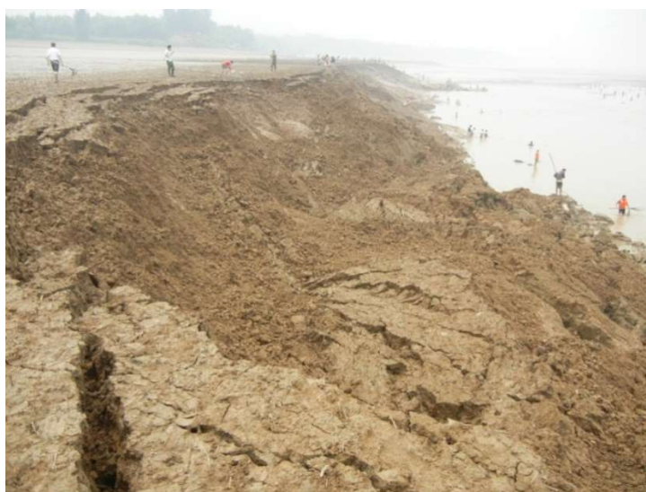
七里工程处坍塌
