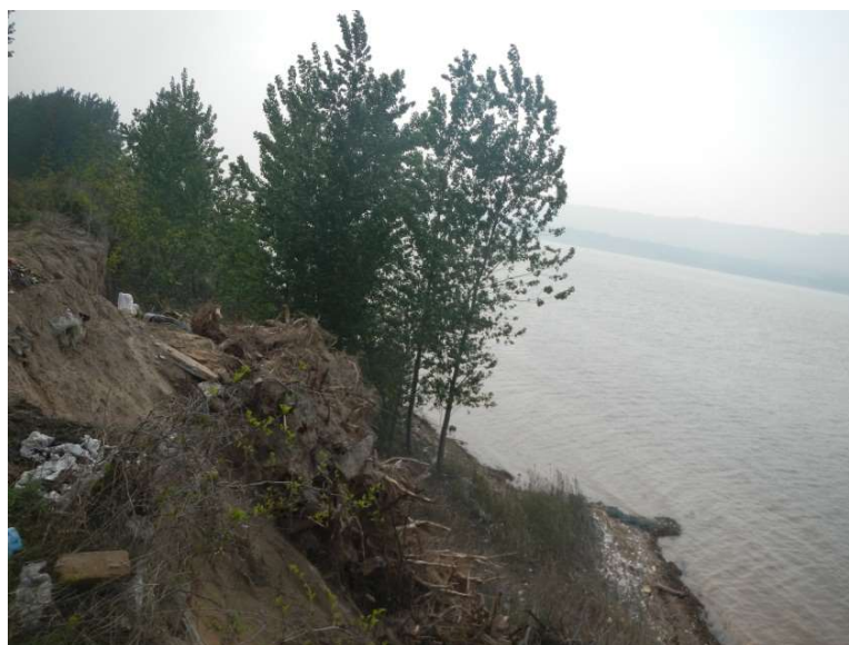
冯佐工程处坍塌
