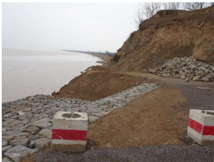
稠桑工程处坍塌
