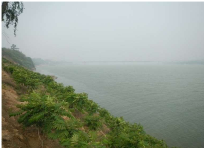
后川工程处坍塌
