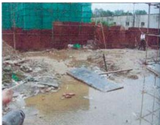
临时排水措施不完善
