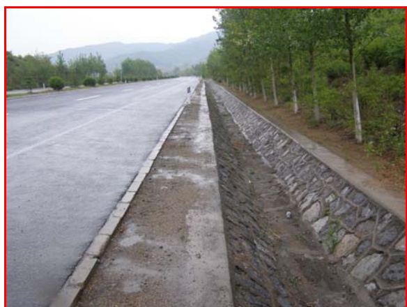
路边浆砌石排水沟
