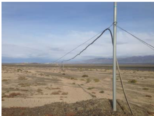
水源井供电线路
