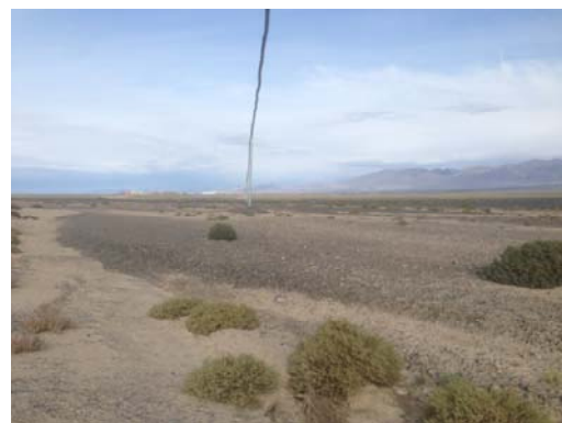
水源井供电线路
