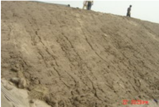
照片 5：填筑边坡流失情况
